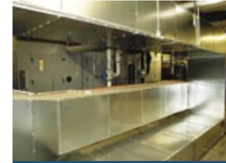
Luchtbehandelingsinstallatie gezien over de kanalen van de lakdroger.
